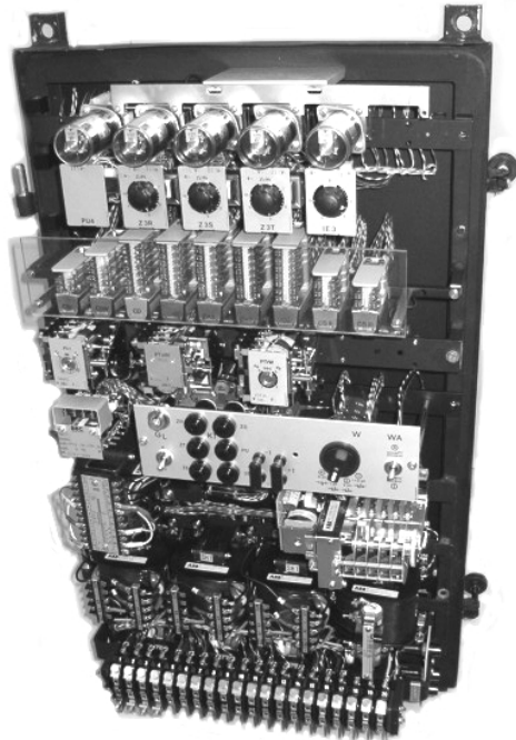
Рис. 4. Шедевр релестроения – электромеханическое реле трехступенчатой дистанционной защиты типа LZ31, выпускавшееся фирмой ASEA в 70-х годах и до сих пор надежно защищающих линии высокого напряжения 110 – 220 кВ во многих странах мира (со снятой крышкой-дверцей).
